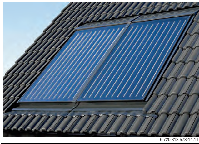
Bild 206 Gesamtansicht Kollektorfeld mit Logasol SKN4.0-s Indach
