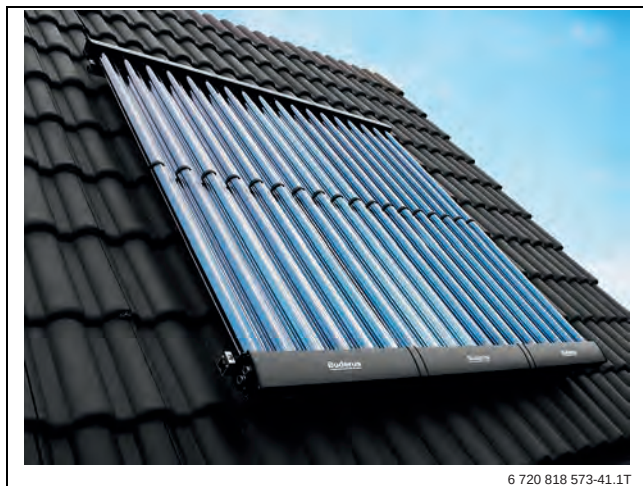
Bild 213 Einbausituation Vakuumröhrenkollektoren Logasol SKR10 CPC
