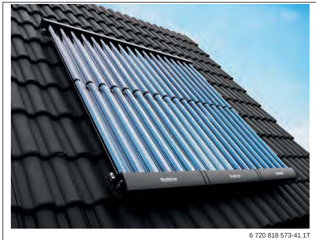
Bild 221 Einbausituation Vakuumröhrenkollektoren Logasol SKR10 CPC
